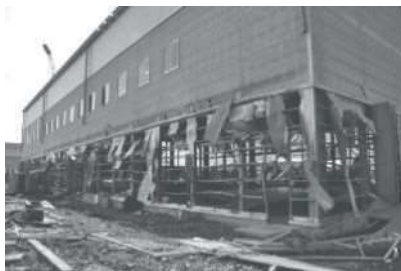
著しく損壊した北日本造船(株)久慈工場
