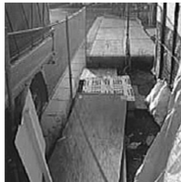
作業後 産廃置き場状況 ・スレート瓦屑の 回収産廃の分別 良好 ・木片・ダンボールのバンドル良好 ゴミカゴ状況
