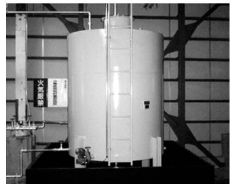
廃油用屋内貯蔵タンク
